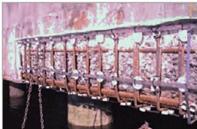
Figura 4 - Il progetto iniziale prevedeva due anodi installati longitudinalmente per ogni lato della trave.
