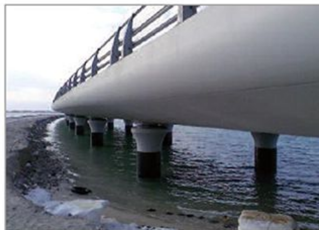
Figura 9 - Il sistema di prevenzione catodica è stato installato con particolare cura per ridurre al minimo l'impatto sull'estetica dei ponti.
