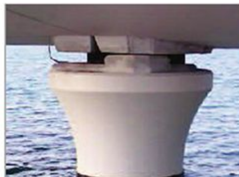
Figura 8 - Testa di un pilastro con sistema di prevenzione catodica installato.
